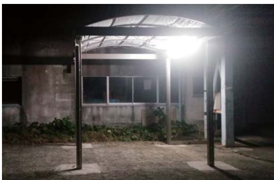
昼間の充電により夜間の防犯灯を点灯させます。
