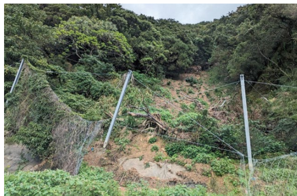
図1 令和5年7月豪雨で生じた越前海岸における斜面崩壊
